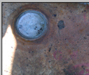
サビ・腐食・漏洩
